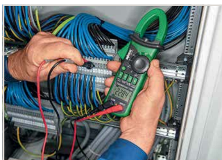
Mesure de courant dans l'armoire de commande
